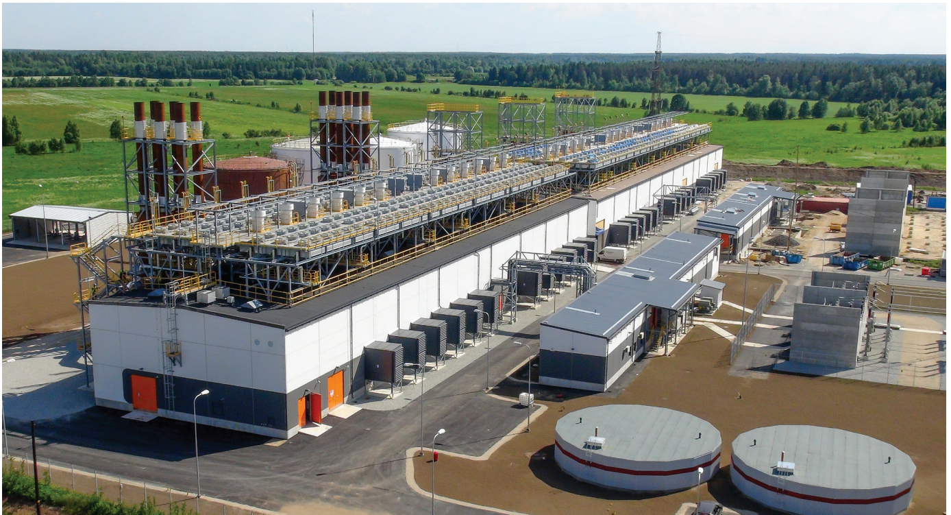
Một nhà máy điện động cơ đốt trong (ICE)
