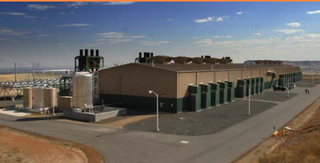
Пиковая электростанция PLAINS END I & II (Колорадо, США) на базе 20 энергоблоков Wärtsilä 18V34SG и 14 энергоблоков Wärtsilä 20V34SG. Общая установленная мощность станции составляет 231 МВт. Основное ее назначение – поддерживать баланс в энергосистеме.
