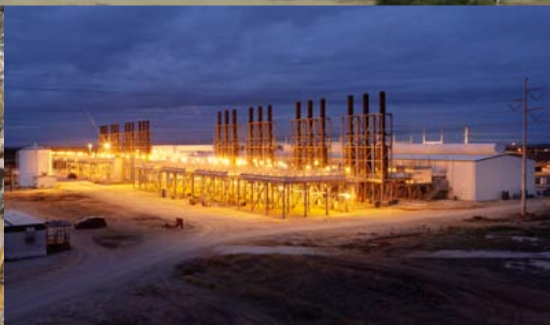
Pearsall, Техас, США. Газомоторная электростанция 200 МВт.
