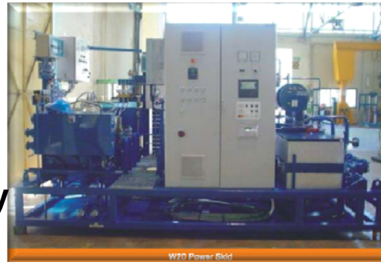
W70 Power Skid
